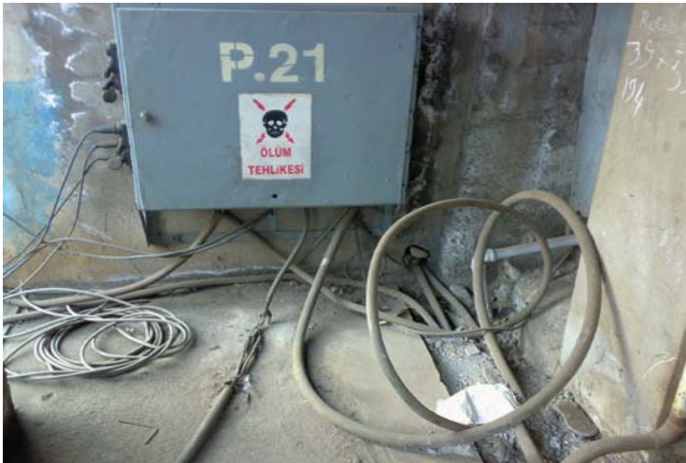
Resim 6.1.9. Uygun olmayan elektrik panoları
