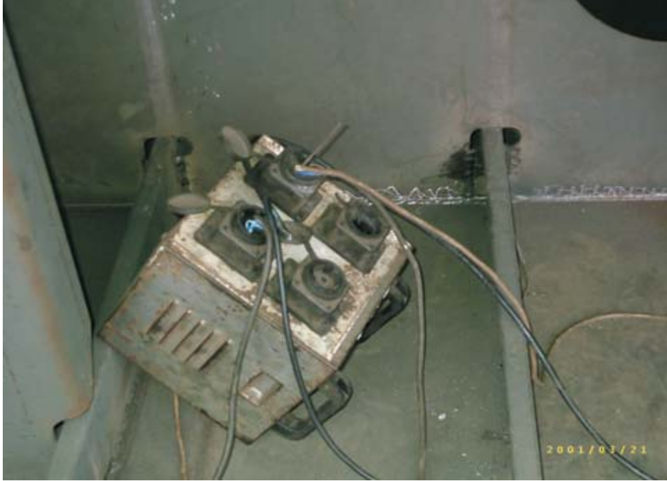
Resim 6.1.8. Prize fişsiz takılmış kablo
