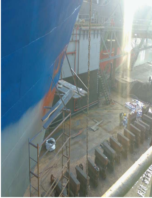
Resim 6.1.2 Uygun olmayan iskeleler
