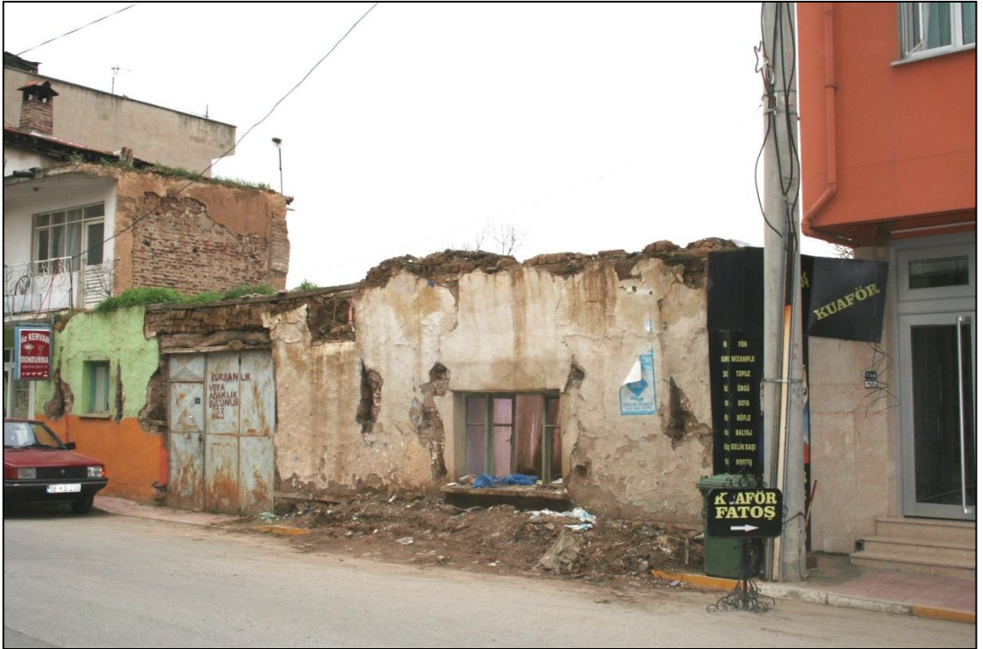
Fotoğraf 95: Günümüzde yapının yalnızca zemin kat ön duvarı ayakta durmaktadır (Ağustos 2010 )
