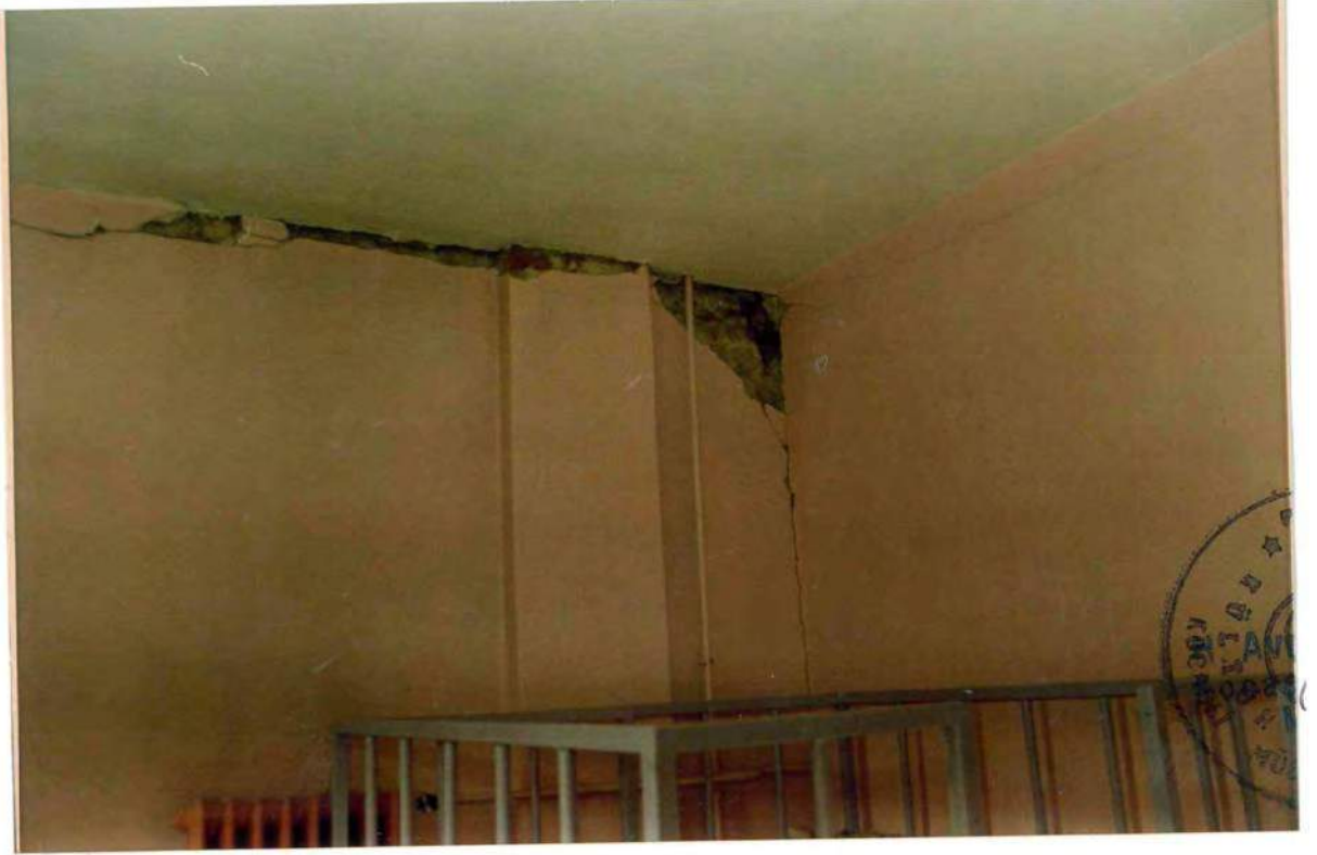
Şekil B.134 : 1999 Depremi Sonrası Yapıda Oluşan Hasarlar(K.K.V.K.B.Kurulu Arşivi)
