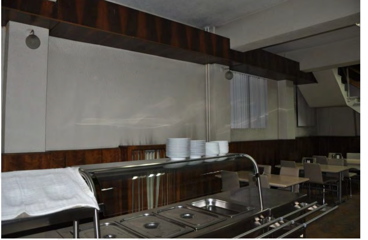
Şekil B.25: Z-15 Güneybatı duvarı
