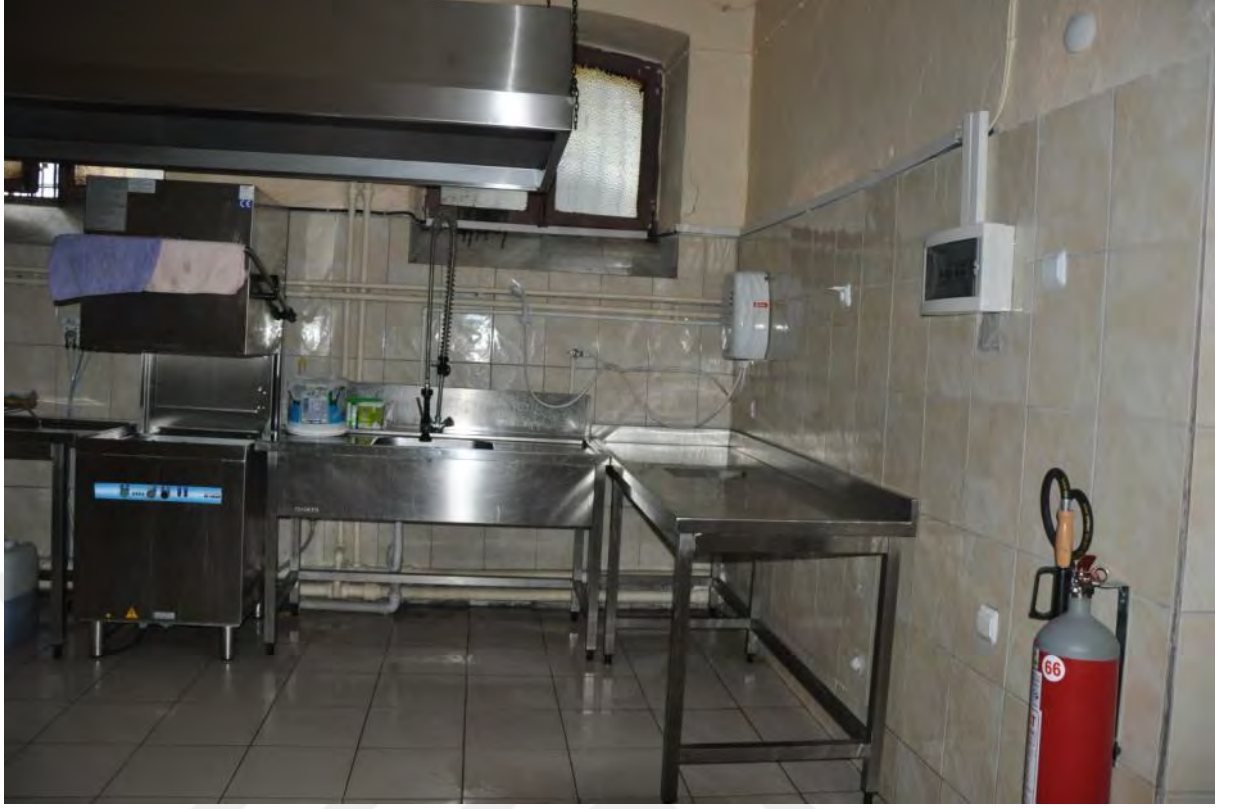
Şekil B.11 : Z-04 Mutfak kuzeybatı duvarı
