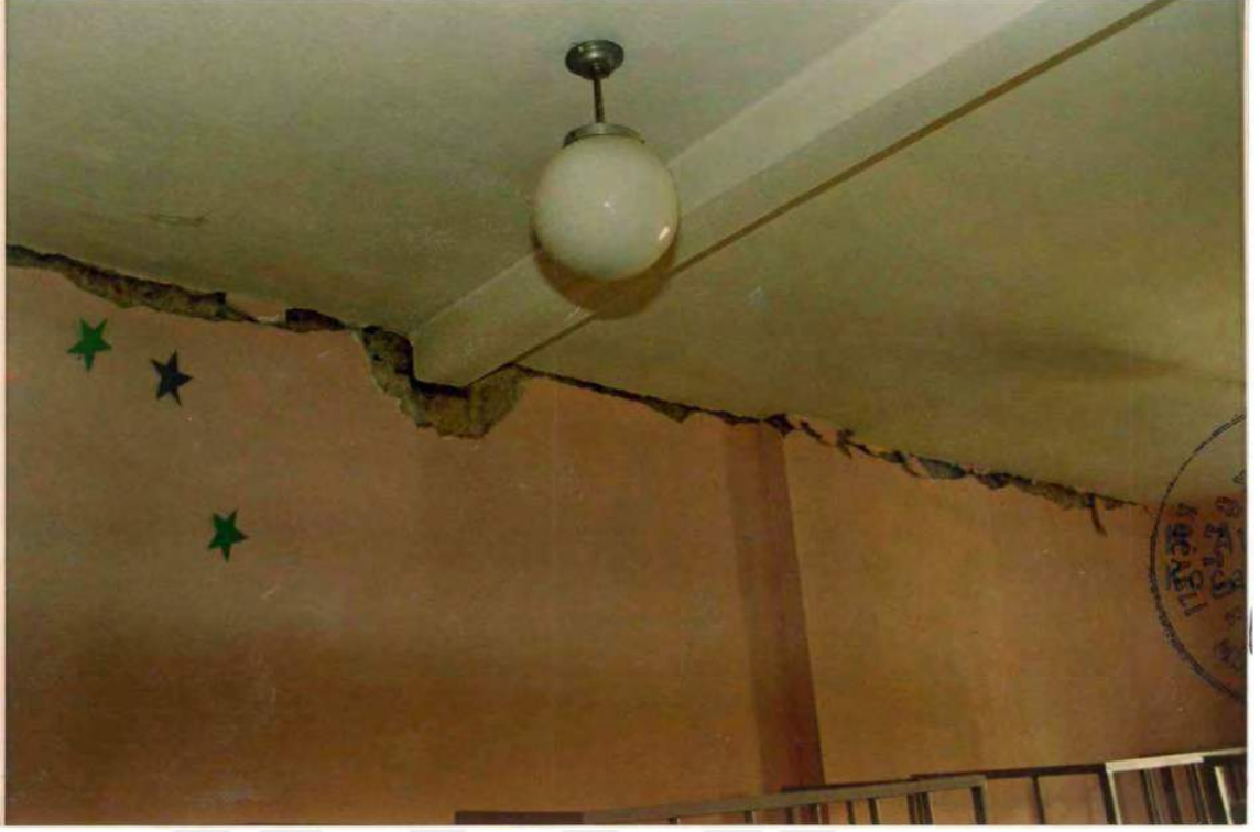
Şekil B.135 : 1999 Depremi Sonrası Yapıda Oluşan Hasarlar(K.K.V.K.B.Kurulu Arşivi)
