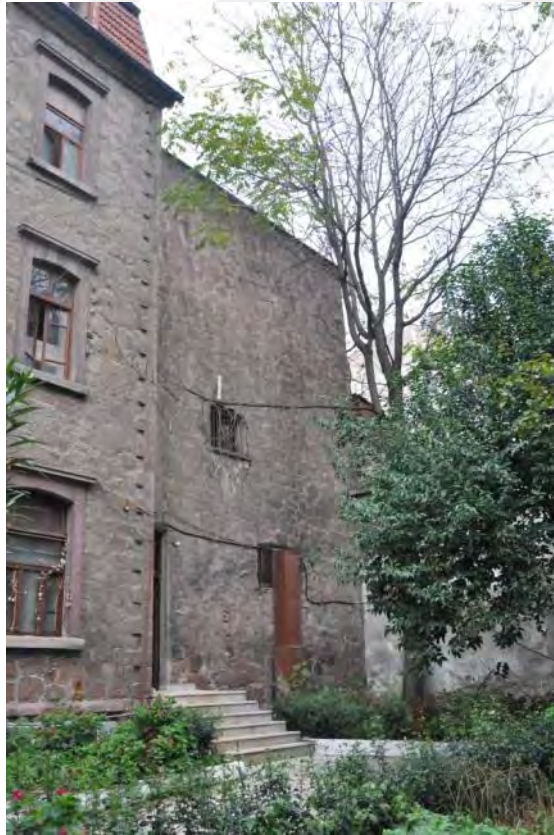
Şekil B.99 : Güneydoğu Cephesi 2018
