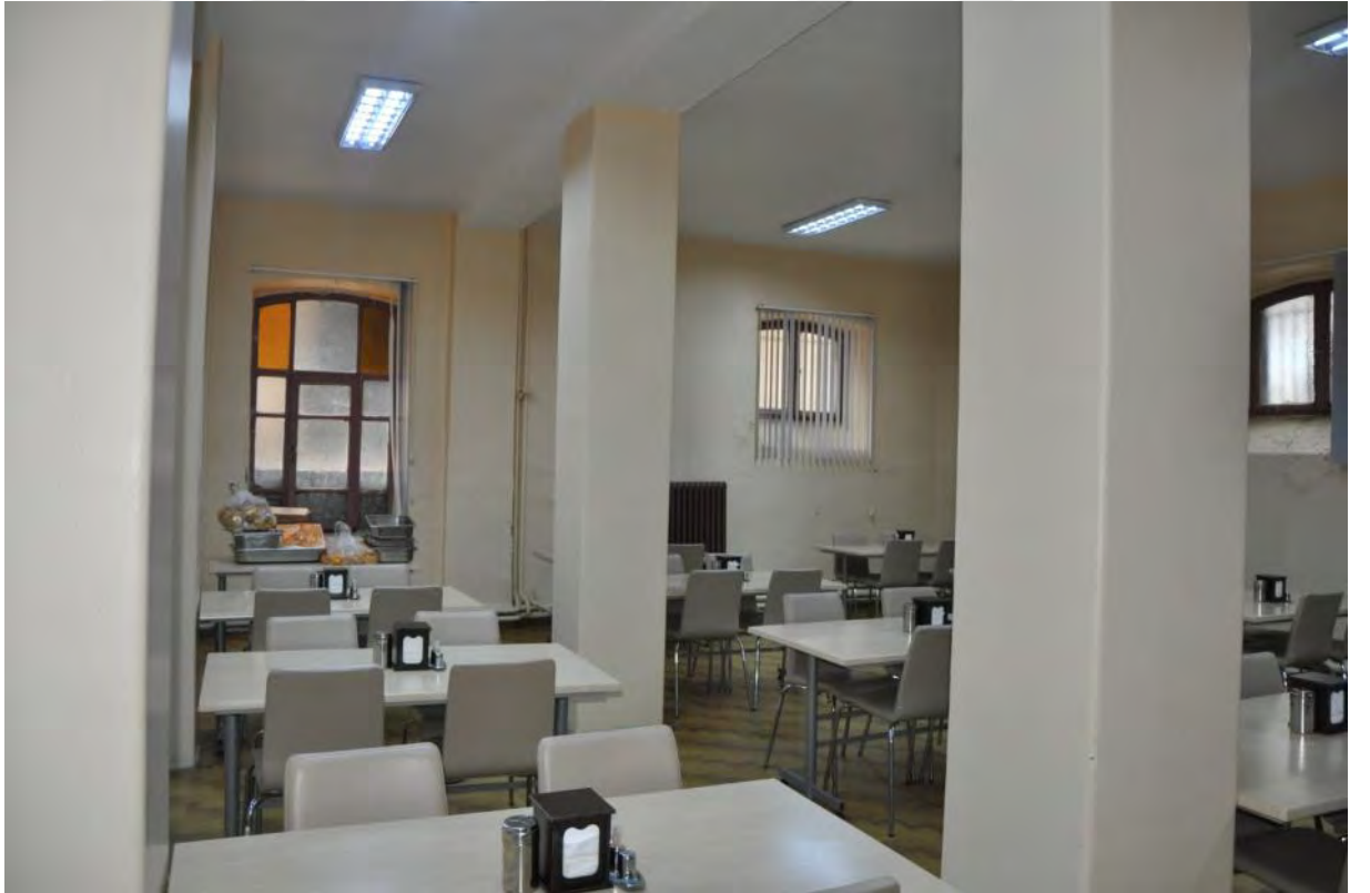
Şekil B.4 : Z-2 Güneybatı duvarı
