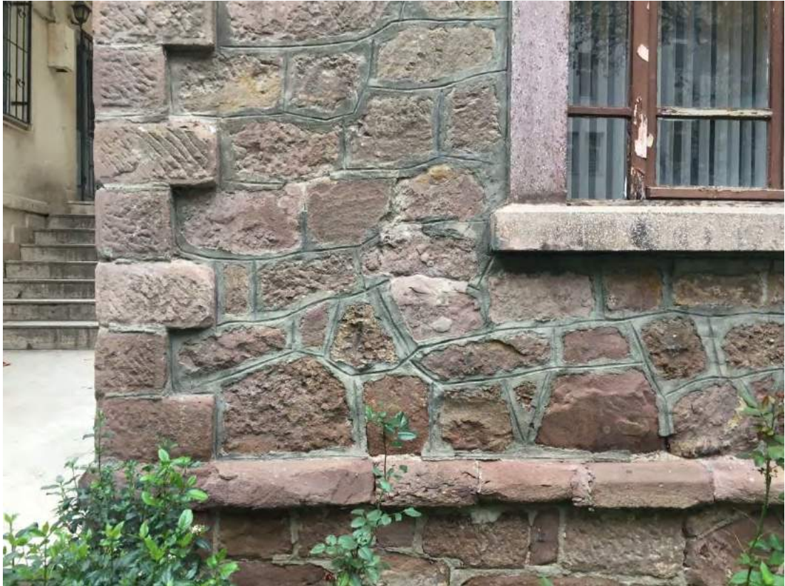
Şekil.6 Yapının Büyük Bölümünün İnşa Edildiği Konglomera Taşındaki Bozulmalar
