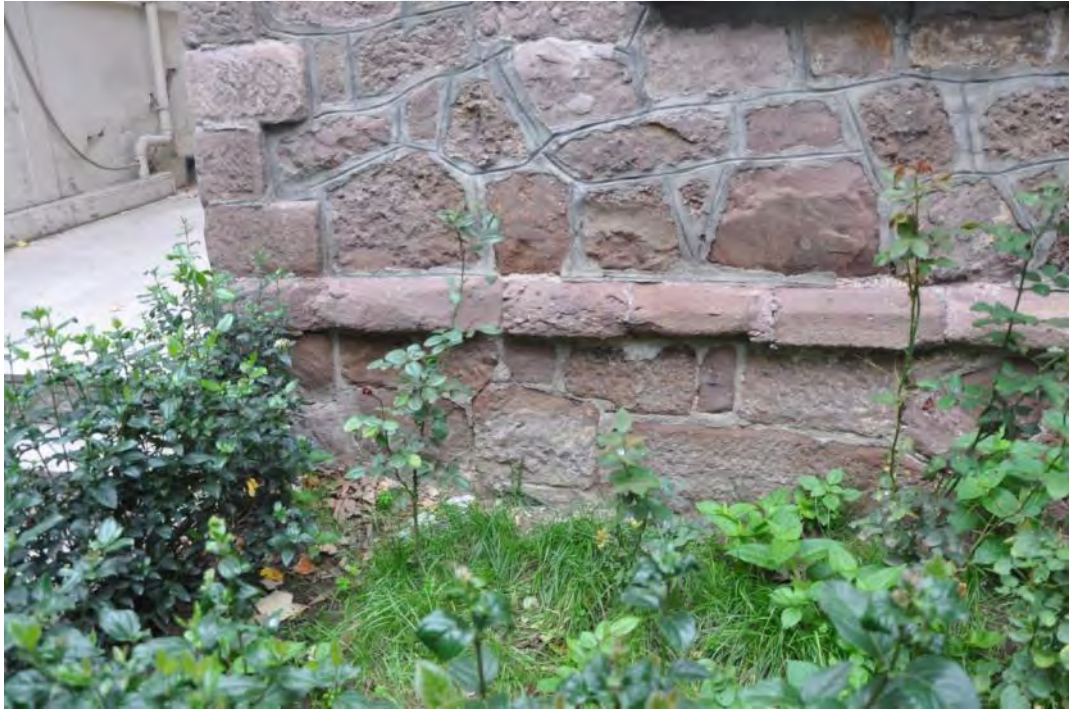
Şekil B.132 : Taş Yüzeyindeki Hasarlar
